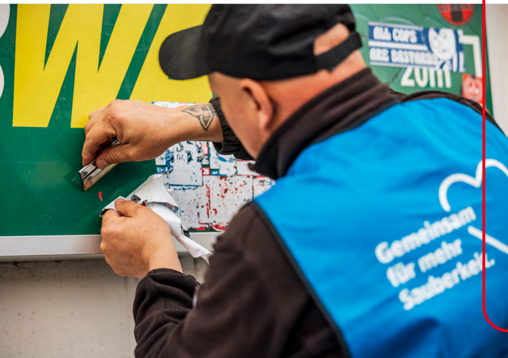
Entfernung von Aufklebern am Bahnhof Amberg
